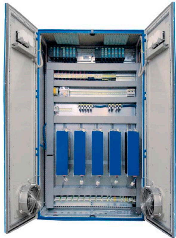
Integration der ELC®-Vorschaltgeräte in den Schaltschrank
